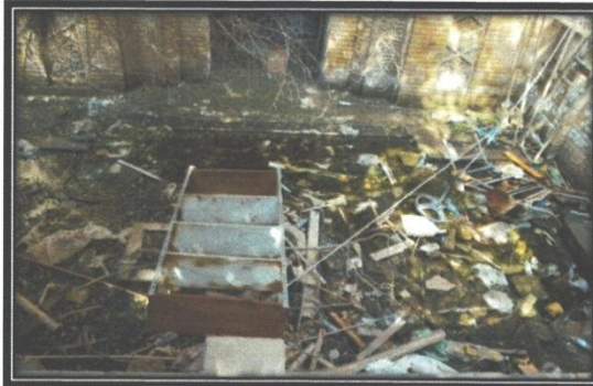
شكل ٢٤: تراكم الاتقاض في موقع بوابة المدرسة و ارتفاع المياه الجوفية المصدر/ تصوير الباحثة
